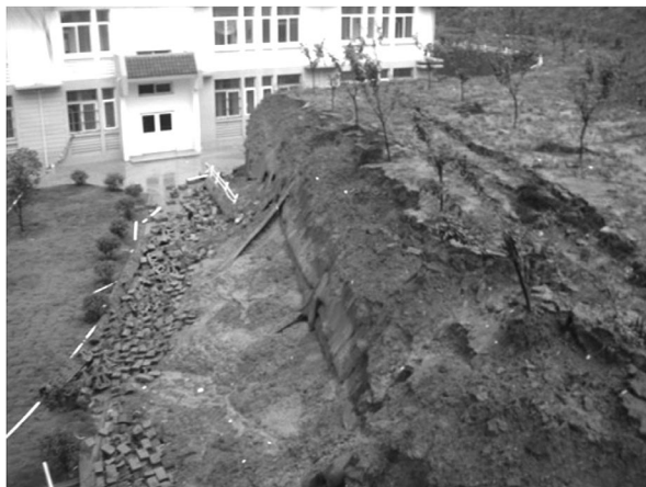
图5 加筋土挡墙倒塌现场照片
