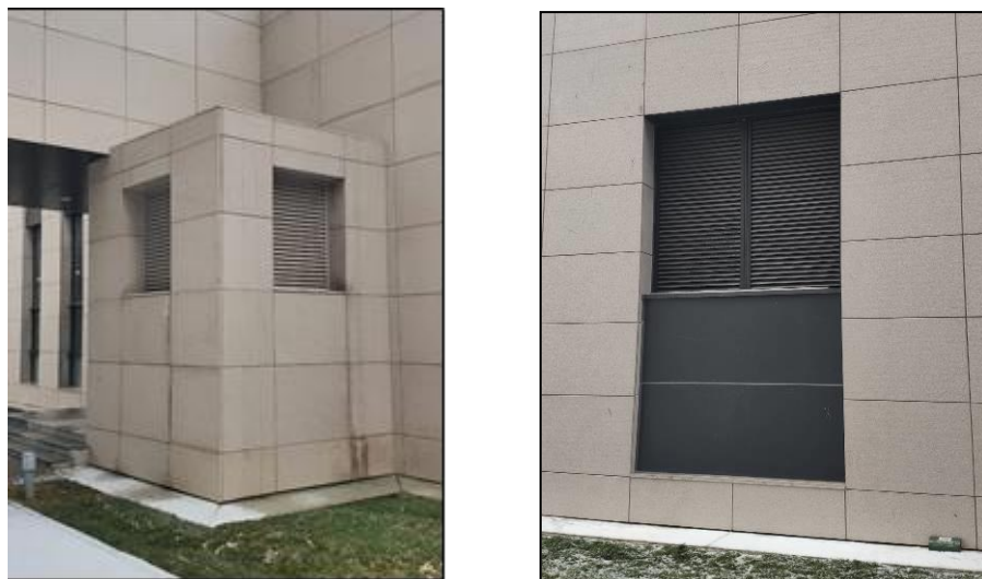
图 4-2 地下车库排风口
