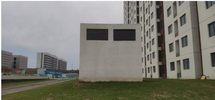
图 4-3 地下车库排风口
